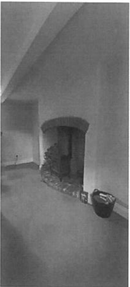
BF RF fireplace - 20220411_10426.jpg
